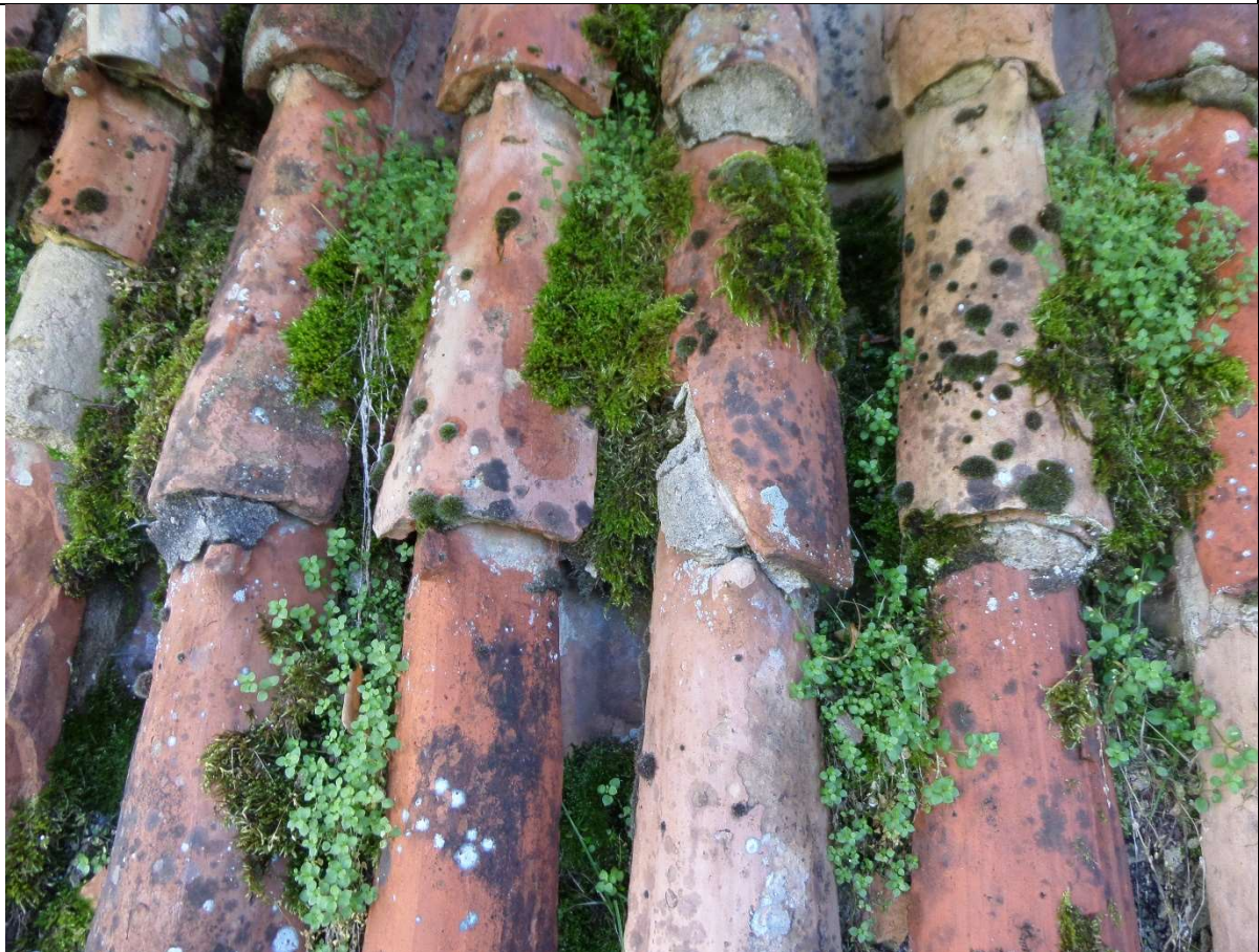
02 stark verschlissene Dacheindeckung
